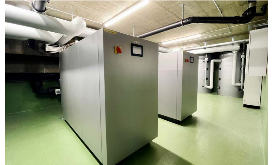
Neue Fernwärmezentrale «Fernwärmeverbund Hallenbad», an der Unterdorfstrasse 18, in Betrieb seit Herbst 2022
