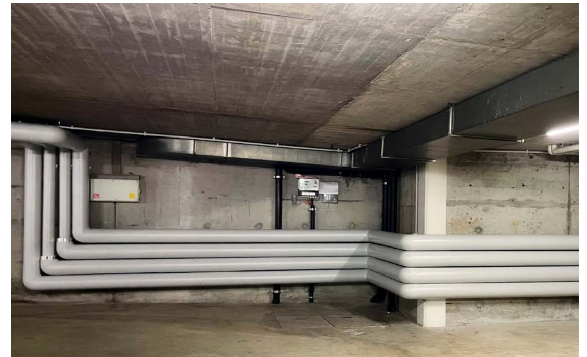
Neue Fernwärmeleitungen «Fernwärmeverbund Hallenbad», in Tiefgarage Unterdorfstrasse 18, in Betrieb seit Herbst 2022
