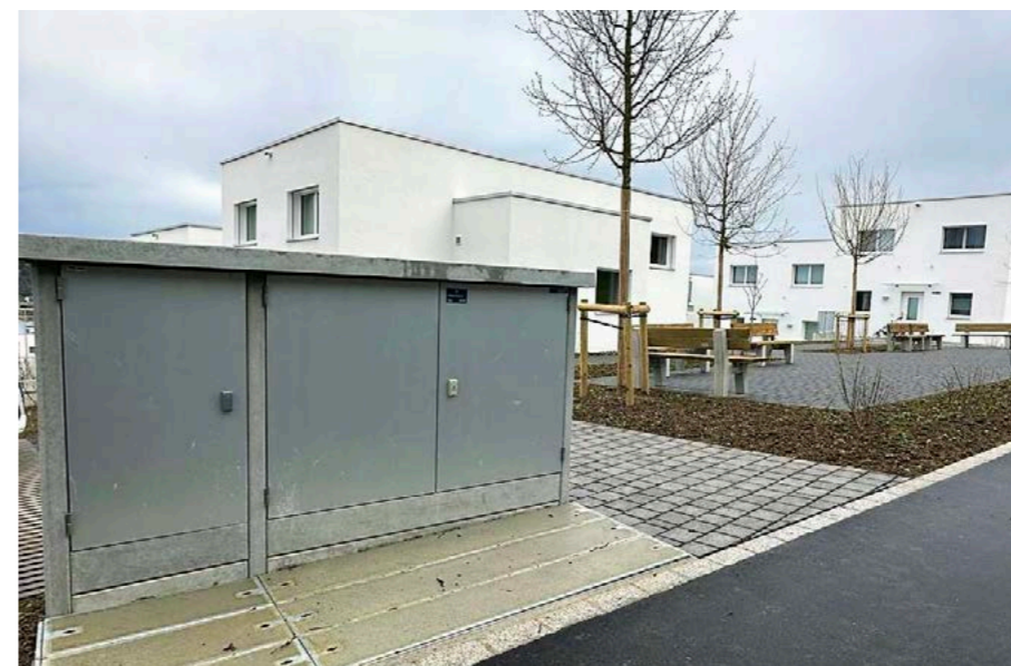
Verteilkabine Retterswilerstrasse, Neubau 2022
